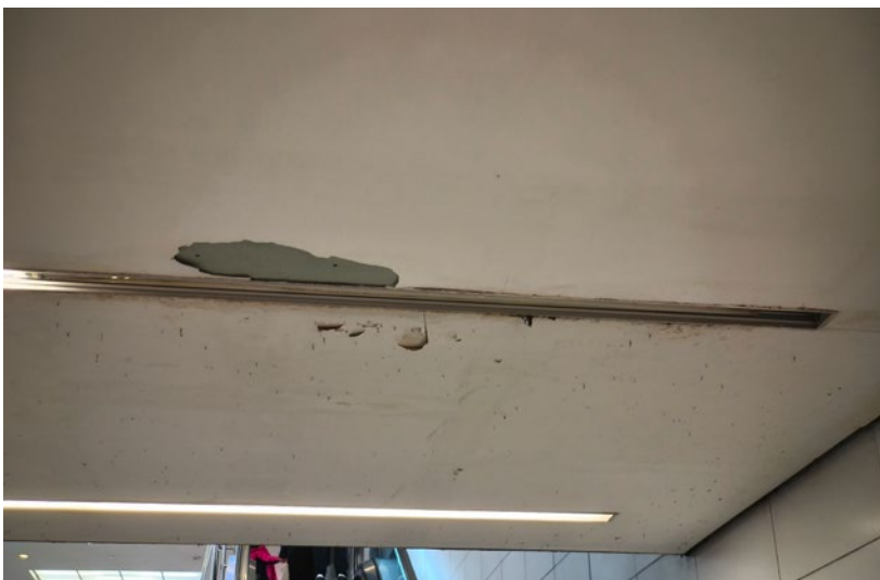
Feuchte Säulen wurden überklebt. Diese Überklebung löst sich teilweise allerdings langsam ebenfalls ab
