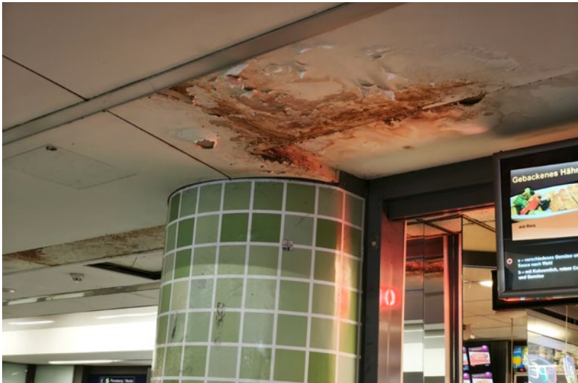
Überall Nässeschäden und viele Feuchtigkeitsflecken an den Decken
